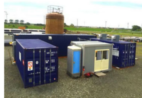
【②Anaerobic Digester (Container Type)】
